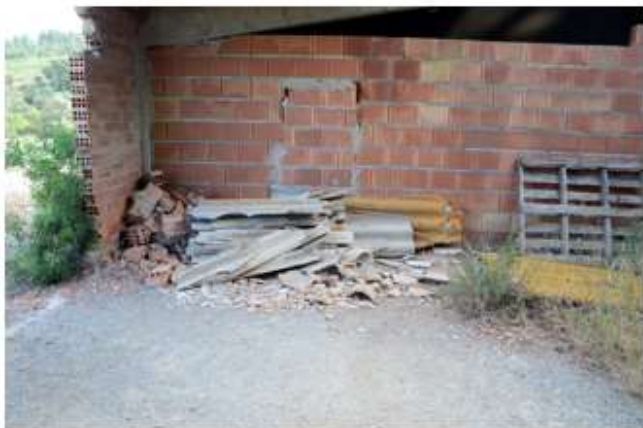
Fragments de fibrociment de la teulada de la nau
